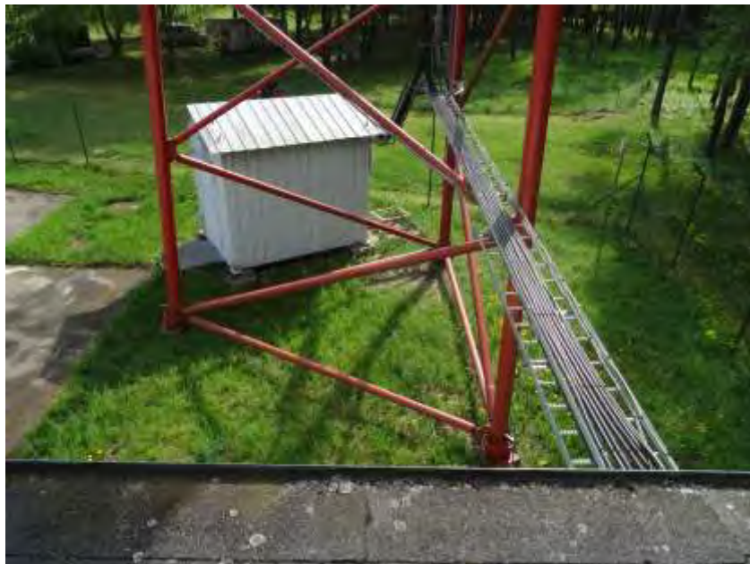
17.skatu punkts (KABEĻU TREPE NO ĒKAS UZ BLAKUS ESOŠO SAKARU TORNI)
