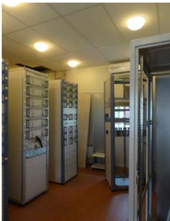
4.skatu punkts (ESOŠĀ APGAISMOJUMA RISINĀJUMS RADIOAPARATŪRAS TELPĀ)
