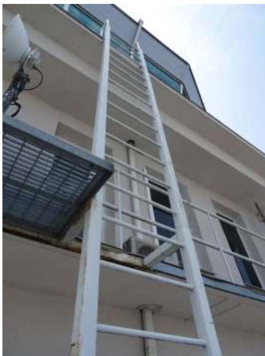
Attēls Nr.3 (Esošās fasādes kāpnes bez drošības elementiem)
