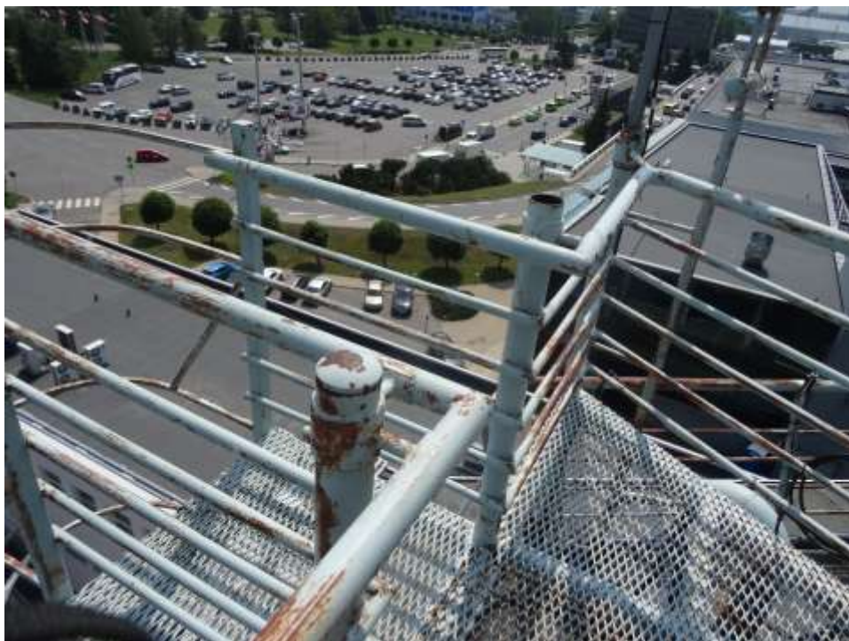
Attēls Nr.7 (Iztrūkstošie metāla vāciņi antenu stiprināšanas caurulēm, 2.platforma)
